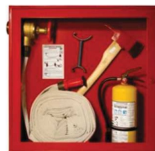
GABINETE CONTRA INCENDIO
